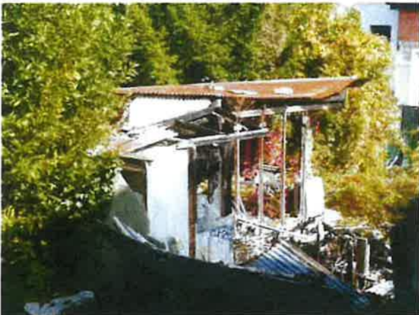
Divers éléments de maçonnerie maçonneries et de toitures pouvant se désolidariser
